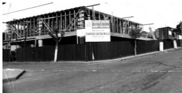
Fig. 81- Foto do início da construção do Edifício Sede. Observar a placa de obra com o nome de Castro Mello. Fonte: Acervo do arquiteto
