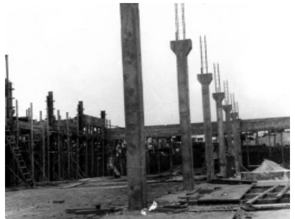
Fig. 27 - Estrutura de concreto armado construída sob a responsabilidade do engenheiro L. A. Falcão Bauer.
