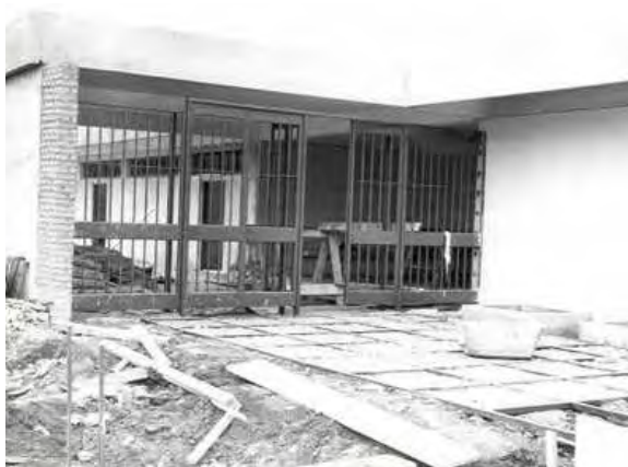
Figura 7: Portão de acesso da Escola Senac de Botucatu. Escadaria de acesso e esplanada em construção. Fonte: Arquivo SENAC-SP
